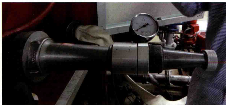
图8-35 检查测压接头是否有端盖
